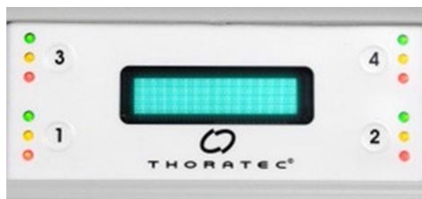
図 3.71 バッテリーチャージャのセルフテスト時のフロントパネル
